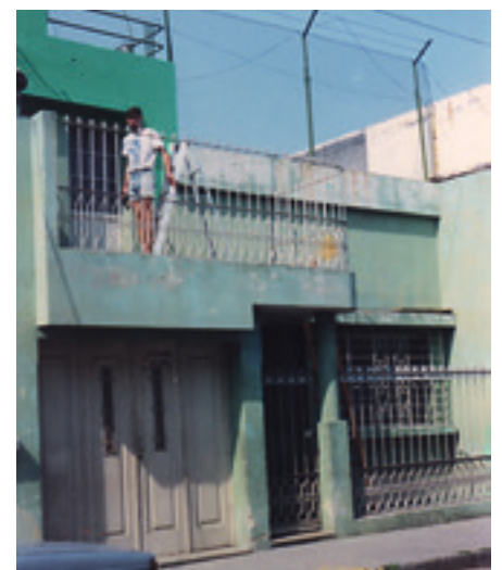
André Beitze faisant de la peinture sur le bâtiment ADM à Guatemala ville en 1989
